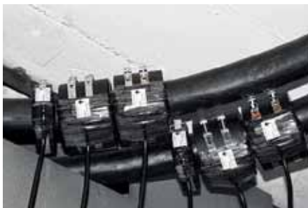
Bild 11: Je ein Sensor und zwei Aktoren zur Summenstrom-Kompensation auf zwei elektrischen Hausanschlussleitungen.
