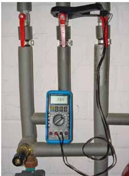
Bild 1: Elektrischer Strom auf Heizungsrohren, gemessen mit einer Stromzange.
